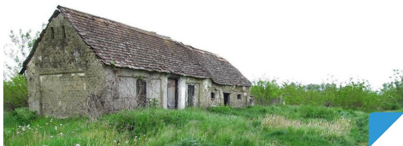
Veszélyesen leromlott állagú ház Kísszentmártonban
